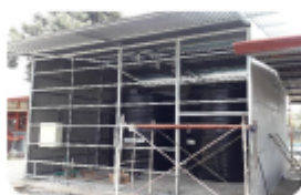
Tanques de captación instalados dentro de caseta.
