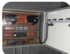
Panel de control de sistema de bombeo de presión constante.
