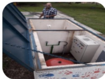
Ubicación de tanque hidroneumático, centro de carga, panel de control de bomba de pozo y clorador.
