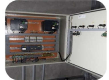
Panel de control de sistema de bombeo de presión constante.
