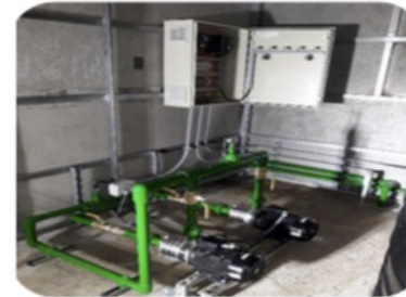
Sistema de bombeo de presión constante, instalado dentro de la caseta.
